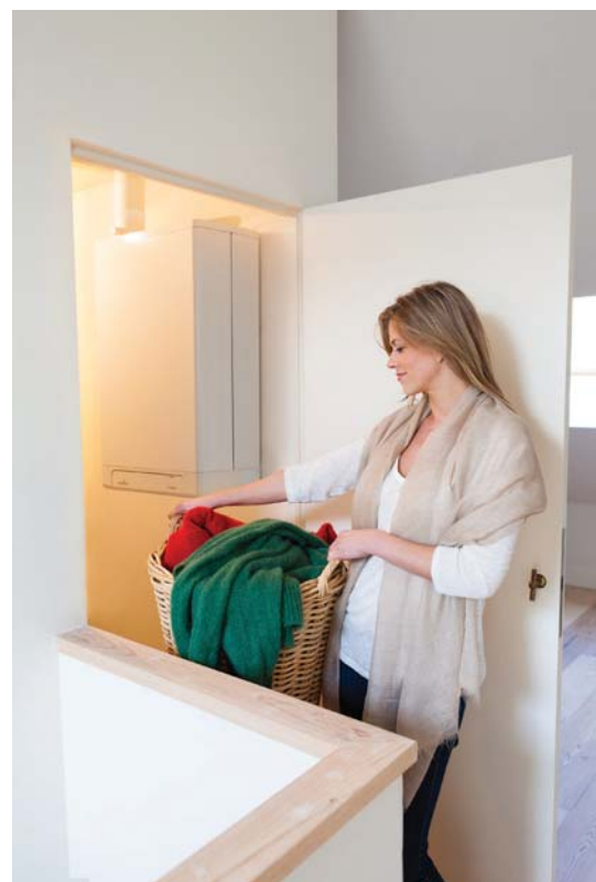
Obstoječa plinska kondenzacijska peč
